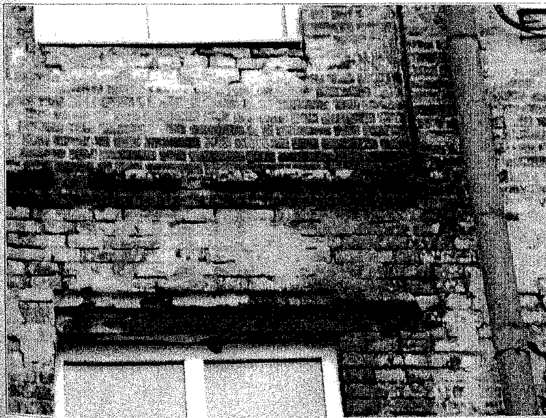
19. «Здание частной гимназии Н.П. Степанова, 1915 г. ». Выветривание раствора в кирпичной кладке стены западного фасада.
