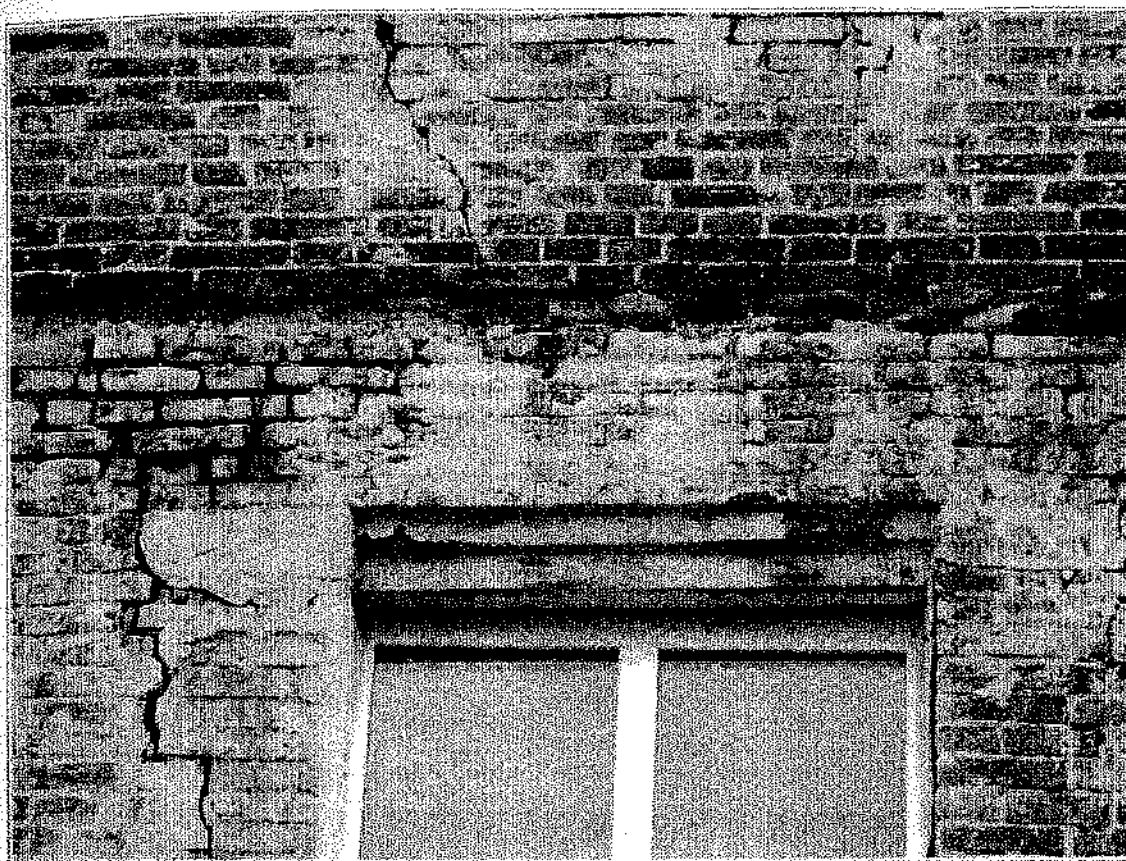
18. «Здание частной гимназии Н.П. Степанова, 1915 г. ». Трещины и разрушение кирпичной кладки стены западного фасада.
